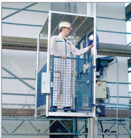
Grind med elektromekaniskt lås på ingångssidan och elövervakad lastramp på utgångssidan.
